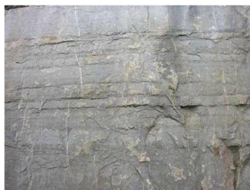
照片 A8 鳞片状起翘与剥落照片
