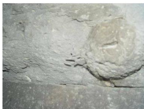
照片 A6 表面粉化剥落
