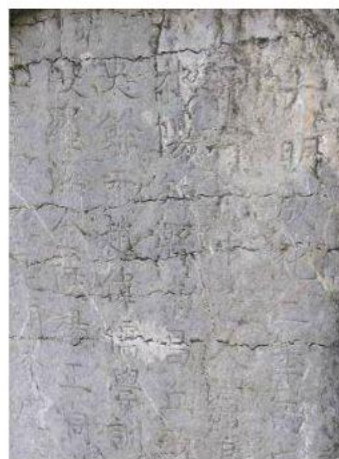
照片 A12 风化裂隙
